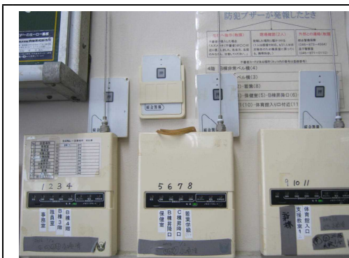
非常通報装置受信機
