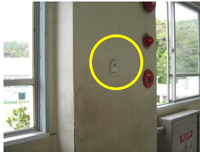
B棟3階、4階廊下（3）（4） B棟非常ベルの横
